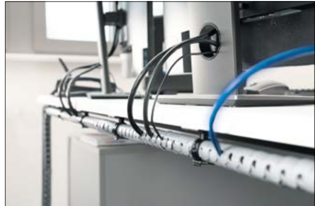
Helawrap - kontor ledningsføring.
