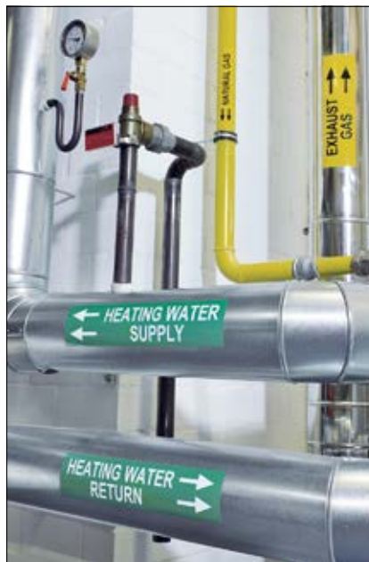
Synlig mærkning af rør.
