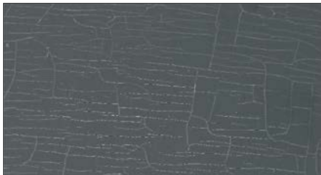
Krydsbindingen er ødelagt på grund af UV stråling.
